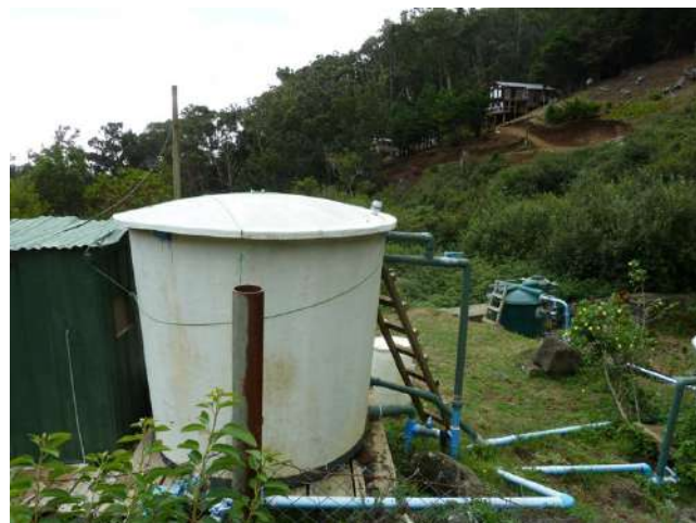
Fotografía 6 Instalaciones de agua para consumo doméstico. Captación Lord Anson.
